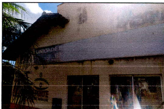
FIGURA 02 - Área externa danificada
