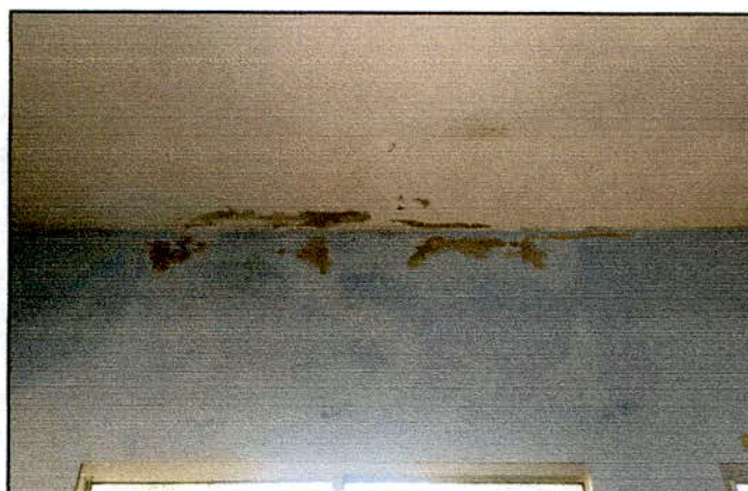
FIGURA 04 - Manchas na parede
