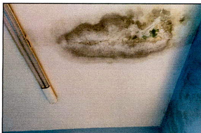
FIGURA 06 - Manchas no teto
